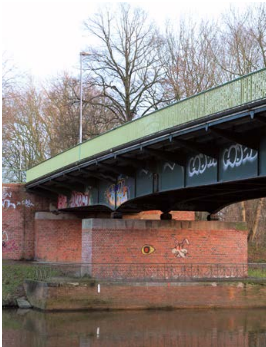
Instandsetzungskosten für die Rehderbrücke: 3 Mio. Euro. Mit einer fachgerecht ausgeführten Sanierung lässt sich die Lebensdauer um 20 Jahre verlängern. (Foto: Thomas-Markus Leber)
