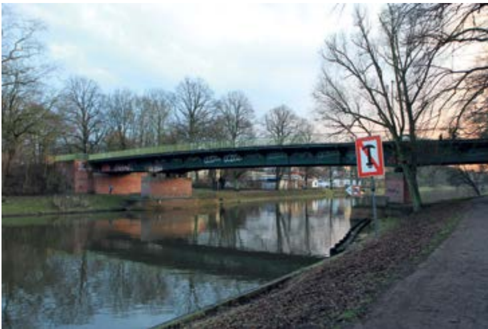
Dr. Stefan Klotz: „Spontanversagen und eine dramatische Verschlechterung des Bauzustandes“ kann bei den alten Brücken nicht ausgeschlossen werden. (Foto: TML)
